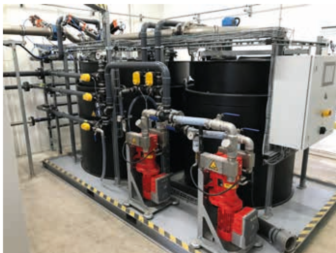
Depot in UK: 2 x TUnit MP Bio Maschinenraum mit 2 x VacUnit DP VX136-140Q, NeutraUnit, (AT und CNT Tank)
